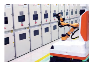
高压配电柜操作
